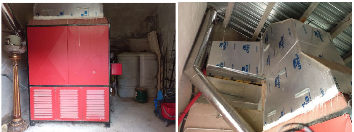
Climatitzador-cremador de gasoil en sala tècnica contigua al Local del Blat
