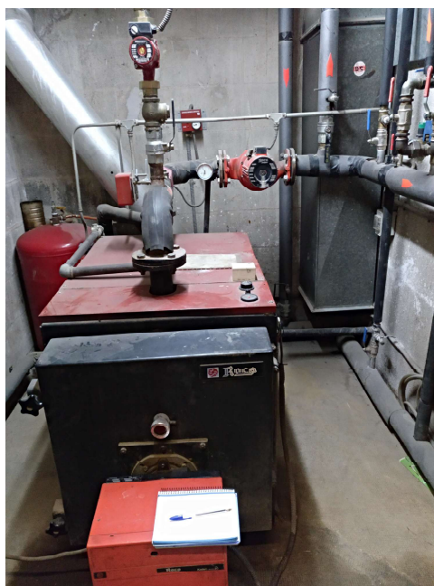
Caldera gasoil Residència Sant Roc
