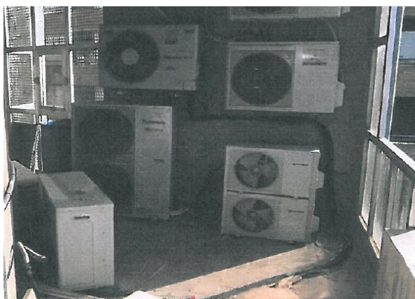
Condensadors de les bombes de calor
