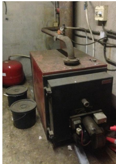
Actual caldera de gasoil de l'Ajuntament
